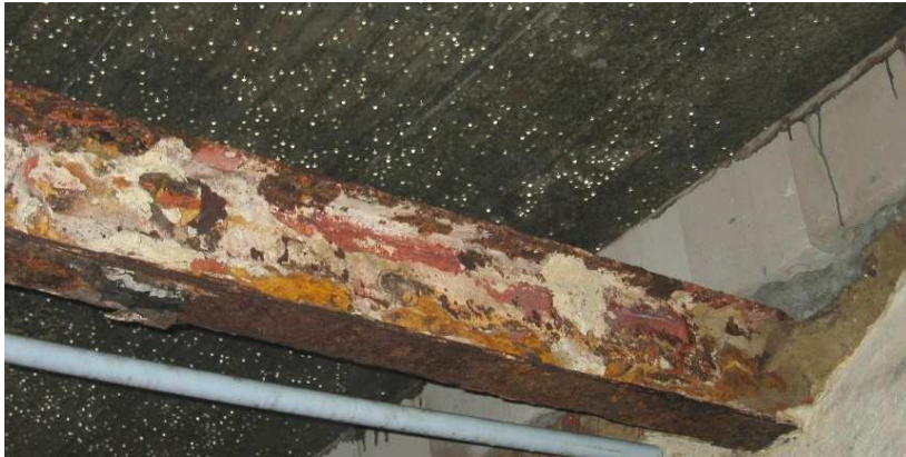
Feuchtigkeitsschäden an Bauteilen
